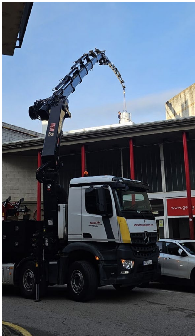
Col·locació d'un dels acumuladors d'aigua calenta sanitària. Foto: GEiEG.
